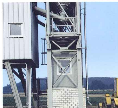
Le conteneur de commande surélevé équipé d'un système de commande MC et d'une composante de courant fort offre une vue dégagée sur la goulotte d'écoulement du malaxeur.
