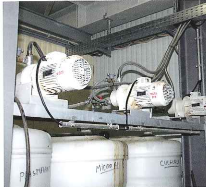
Les cuves en plastique de stockage d'additifs sont remplies à partir du niveau \pm 0 . Toutes les conduites de remplissage sont centralisées.
